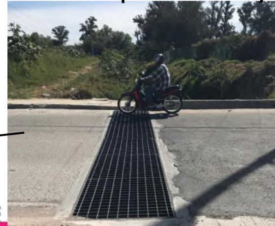
Alcantarilla para la captación al arroyo
