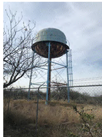
Tanque de regulación
