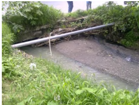
Cruce con vialidad azolvado
